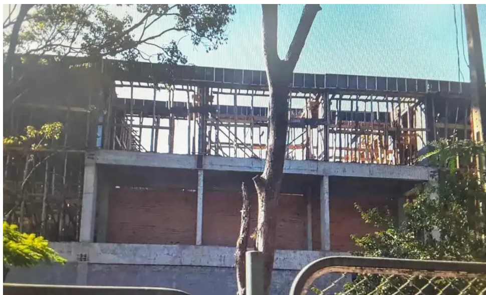
A retomada do Bloco Q-07 na UEM foi feita com as condições de segurança e uso de EPIs
